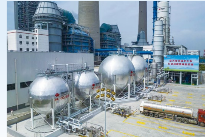
泰州电厂碳捕集利用封存（CCUS）示范工程
