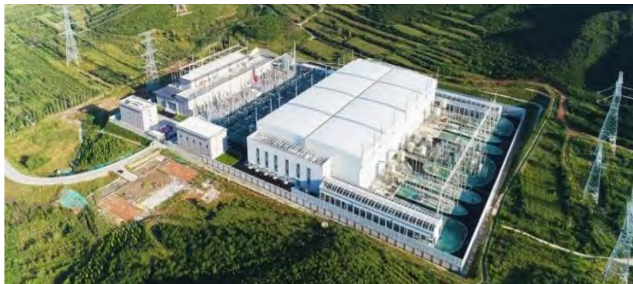
应用该装备的张北柔性直流工程换流站
