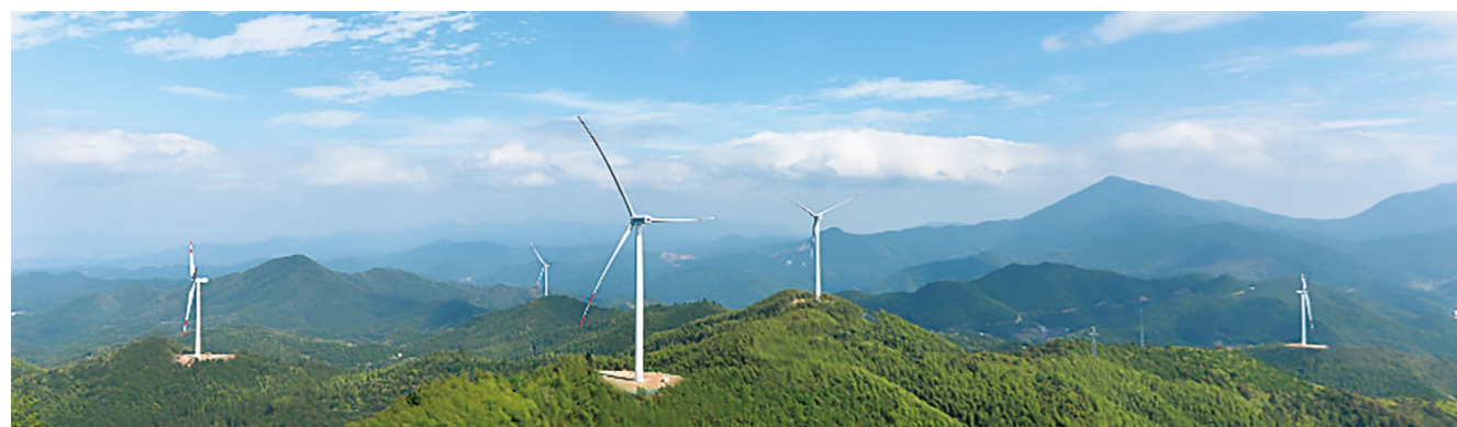
广东南雄风电场 Nanxiong Wind Farm, Guangdong
