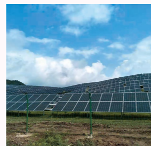
光伏发电 PV power generation
