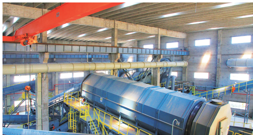
水泥窑协同处置固体废弃物老河口示范线
