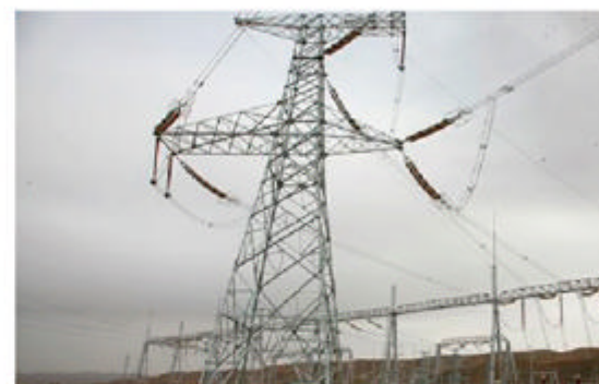
▲ 甘肃省院总承包的地震灾区恢复重建项目配套工程——榆中330千伏送变电工程竣工验收
