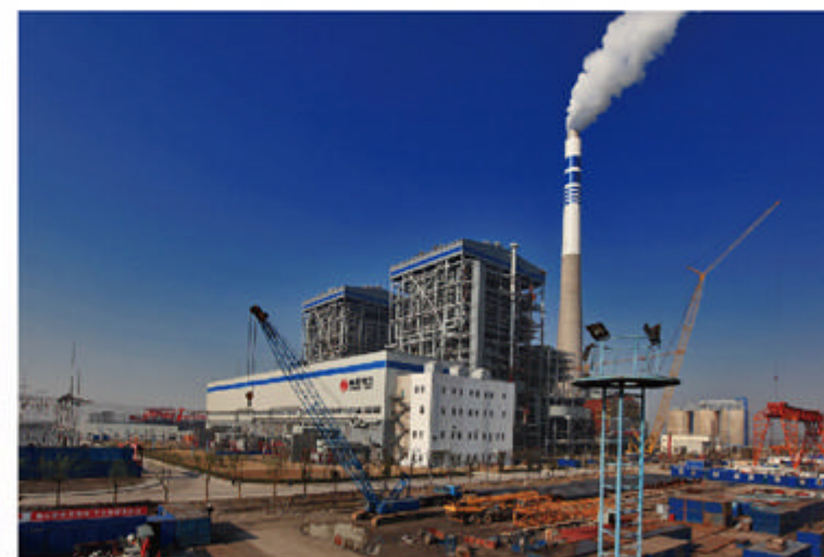
▲ 中国能建总承包的马鞍山电厂“上大压小”扩建2×66万千瓦机组工程投产,成功跑出能源建设EPC“中国道路”
