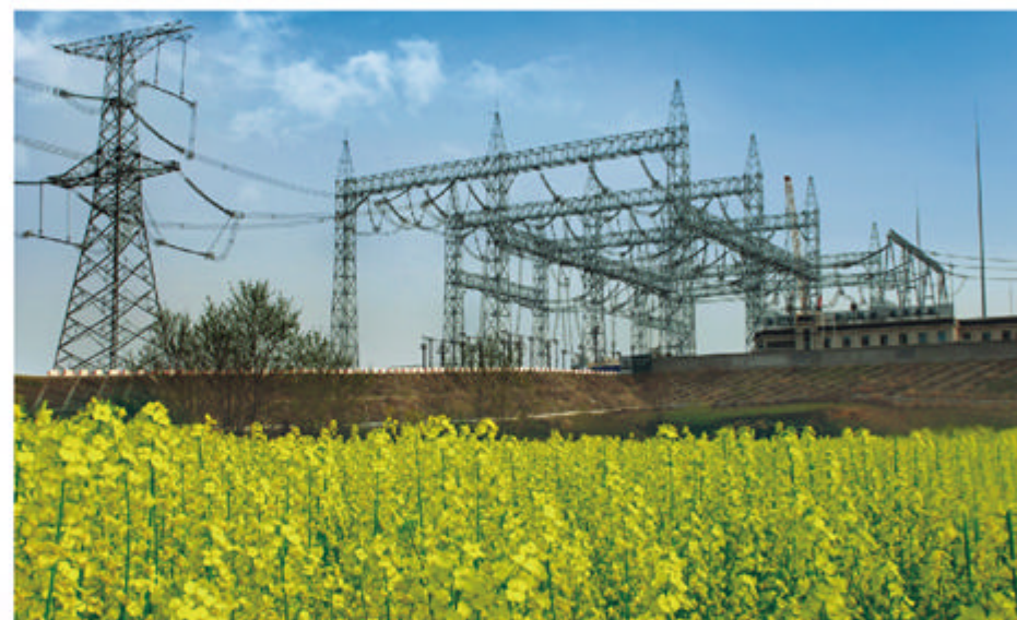
▲ 特高压交流试验示范工程荆门变电站
