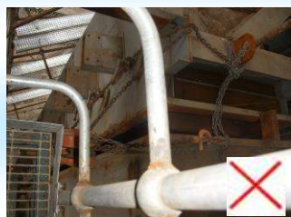
链条葫芦吊钩直接钩挂在型钢、吊耳上使用，易产生吊钩变形
