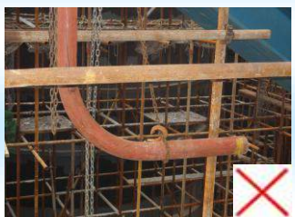
链条葫芦吊钩直接捆绑吊物使用，易造成吊钩受力变形、损坏
