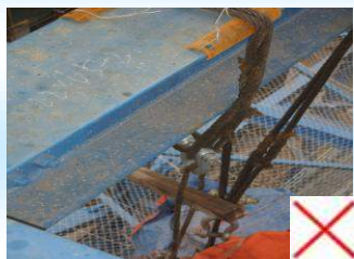
锅炉炉前侧抛锚下降管的卸扣已变形，存在严重安全隐患
