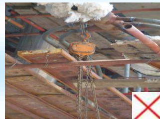
锅炉房管道安装的链条葫芦吊钩已变形，存在严重安全隐患
