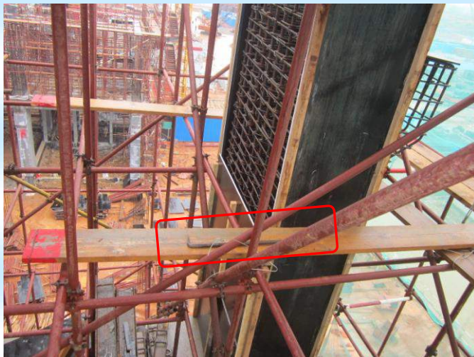
高处作业面工具放置不安全
