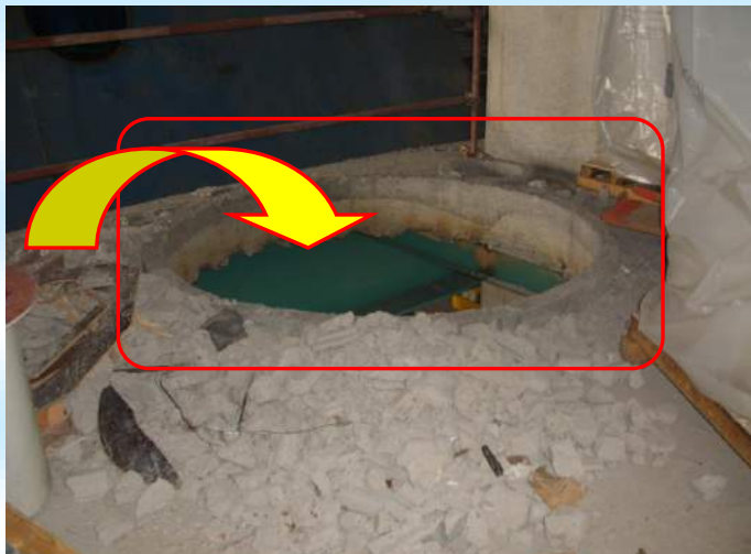
高处作业面孔洞无防护措施
