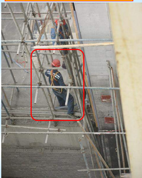
高处作业人员未正确系挂安全带
